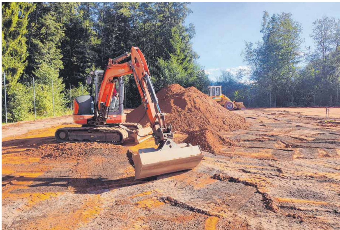
Die Plätze fünf und sechs des TC Isny werden seit Montag umgebaut. Im Oktober soll hier auf sogenannten Allwetterplätzen gespielt werden können.
